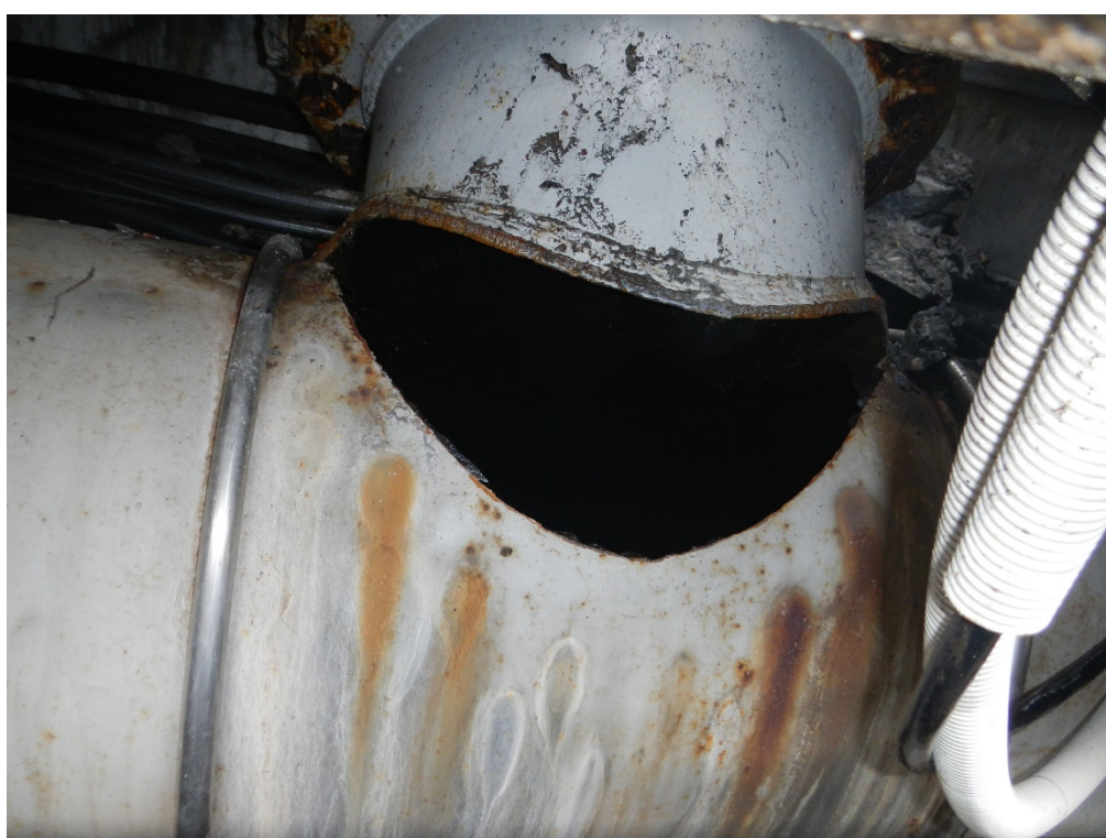
破損した二次冷却系統配管
